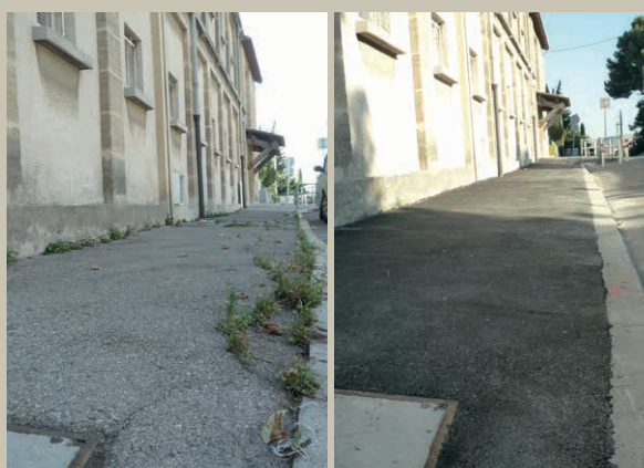
Rénovation du trottoir de l'école, boulevard de Bellevue - quartier les Borels (15 e )
